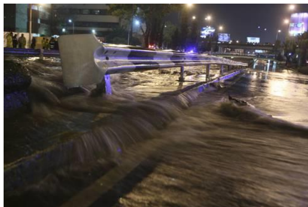
Figura 2.8 Colapso del drenaje en Viaducto Miguel Alemán en abril del 2011. Fuente: La jornada.
