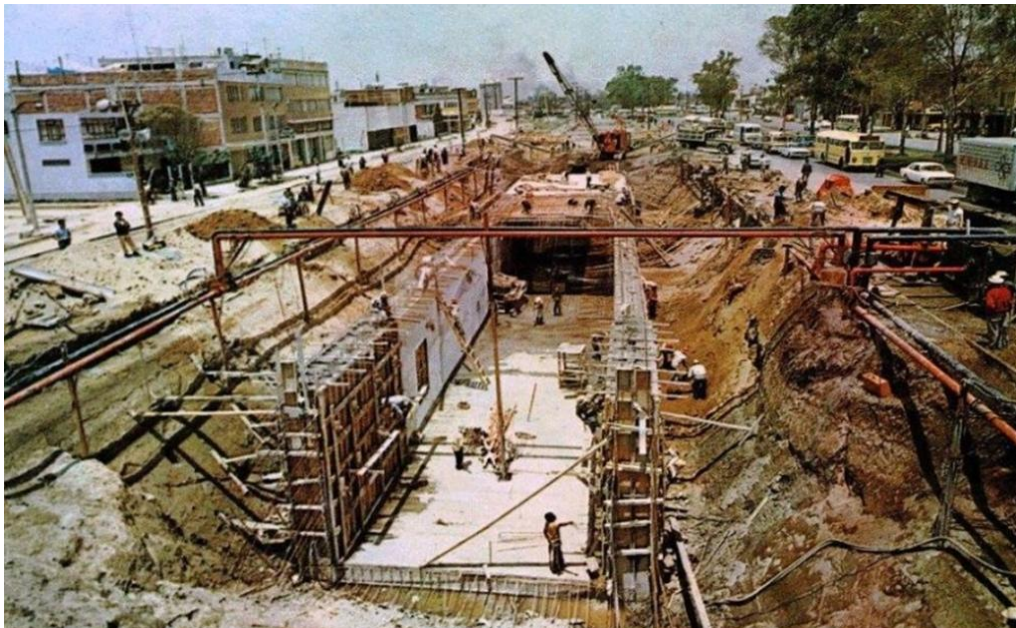
Figura 19. Inicio de los trabajos de construcción de la línea A del sistema Metro (DDF, 1968).
