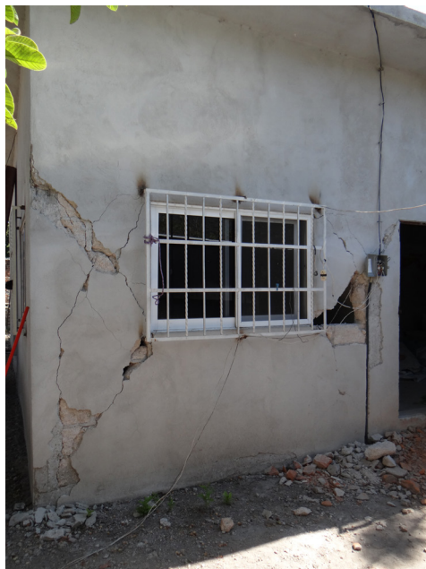
4.7 Fotografía en donde es evidente que las grietas parten y siguen desde las esquinas de los vanos de la vivienda
