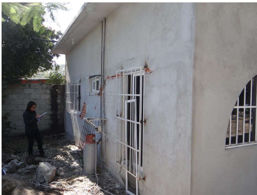
4.2 Evaluación y levantamiento de los daños
