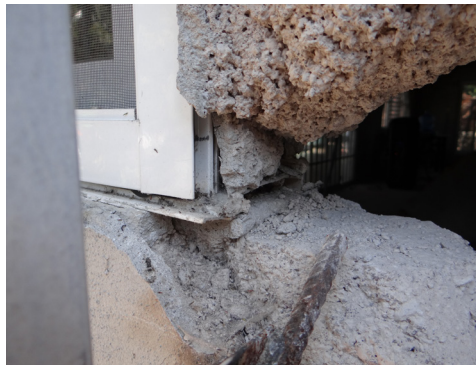
4.6 Fotografía en donde se aprecia la falta de cerramientos en los vanos de la vivienda, una de las principales causas de los daños por el sismo
