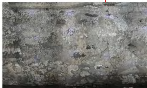
El rodapié del paramento presenta mayor humedad por capilaridad ascendente.
