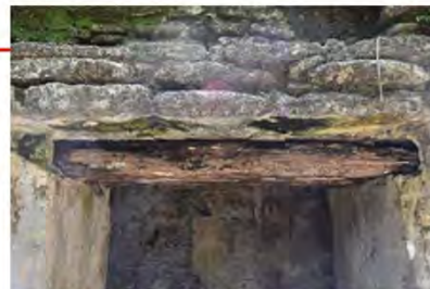
Pudrición y desintegración de los tres dinteles
