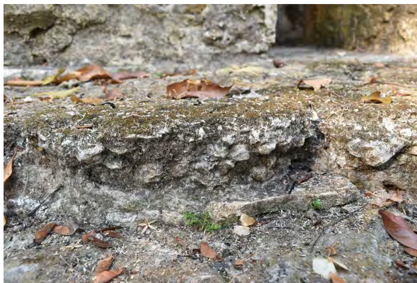
Figura 5.25 Restos del recubrimiento de la techumbre. Se pueden observar la última laja y sobre ella el firme de grava, gravilla y la capa de cal. (E. Tejada, 2019).
