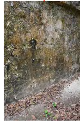
Microflora en todo el paramento, concreciones salinas en la esquina de la cruja y pulverulencia en el recubrimiento de estuco.
