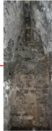
Humedad en el rodapié del muro. Eflorescencias en el recubrimiento de estuco.
