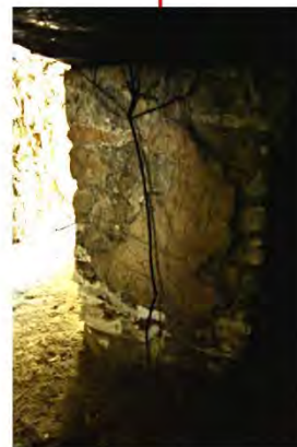
Humedad por capilaridad, condensación y filtración. Fisuras por acción salina. Invasión de microflora y raíces de plantas vasculares.
