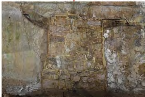
Presencia de sales y algas en paramentos y bóveda. El rodapié se observa húmedo por capilaridad ascendente.
