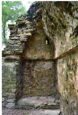
Pulverulencia en el recubrimiento. Presencia de algas en paramento e intradós. Fisuras y grietas por migración de sales.
