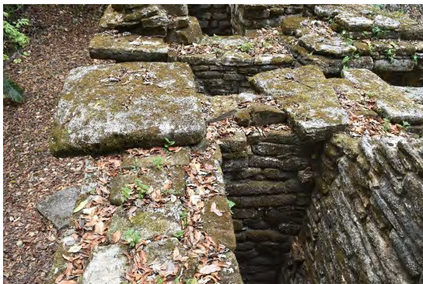
Figura 3.19 Losas en los cabezales de los muros de los Edificios 24 y 25, Yaxchilán, Chiapas. (E. Tejeda, 2019).
