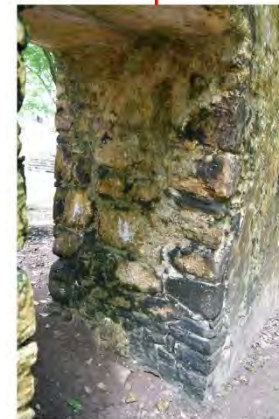
Humedad por capilaridad ascendente y escurrimiento. Invasión de algas. Disgregación por deterioro bioquímico. La junta de los sillares de la jamba intervenidos recientemente.
