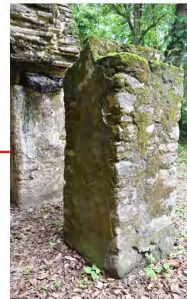
Humedad por capilaridad en la base del pilar. Microflora y musgo cubren el estuco y la mampostería.
