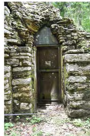
Puerta de madera deteriorada y mala plástica rota
