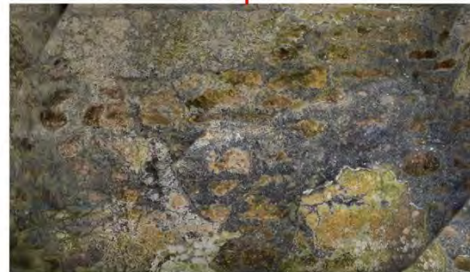
Muros de la cruzía completamente cubiertos por algas. Humedad en rodapiés y fisuramiento por migración de sales.
