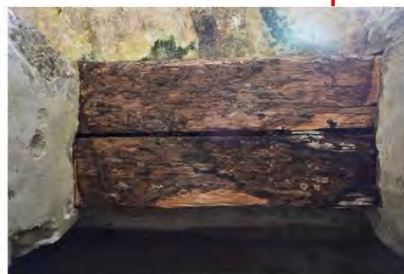
Los tres dinteles se encuentran húmedos, agrietados y en estado de desintegración.
