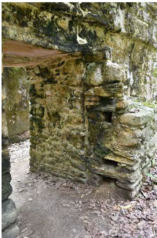
Figura 5.39 Restos del contrafuerte de la crujía suroeste. (E. Tejada, 2016).
