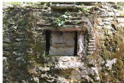
Restos de estuco modelado pintado amenazado por deterioro bioquímico
