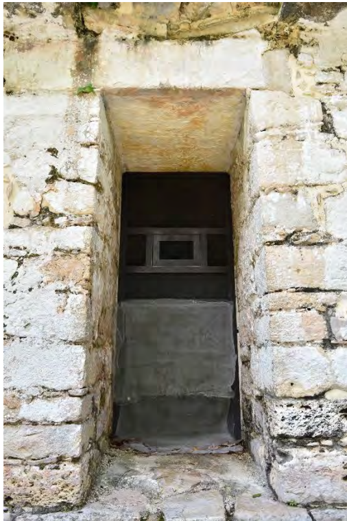
Figura 4.22 Acceso protegido con una puerta de aluminio y malla plástica, Edificio 33, Yaxchilán, Chiapas. La malla ha sido remendada con otro material por falta de mantenimiento y recursos. (E. Tejeda, 2018).
