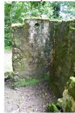
Humedad en el arranque del muro por acumulación de sedimento y hojarasca. Paramento cubierto por algas y musgo.
