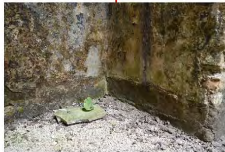
Paramentos cubiertos por algas y concreciones salinas. En el arranque del muro se observa la huella arquitectónica de la existencia de una banqueta, retirada durante la época prehispánica.
