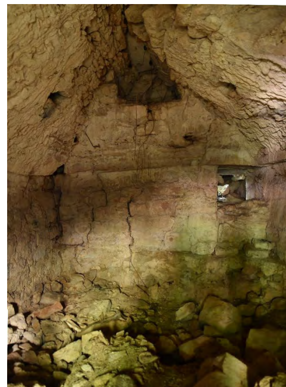
Figura 4.26 Piso y banqueta destruidos por el saqueo, Edificio 88, Yaxchilán, Chiapas. (E. Tejeda, 2018).
