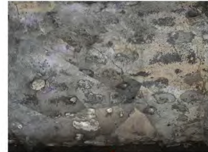
Paramentos y bóveda con eflorescencias salinas de color gris oscuro. Fisuras en el recubrimiento de estuco por migración de sales.
