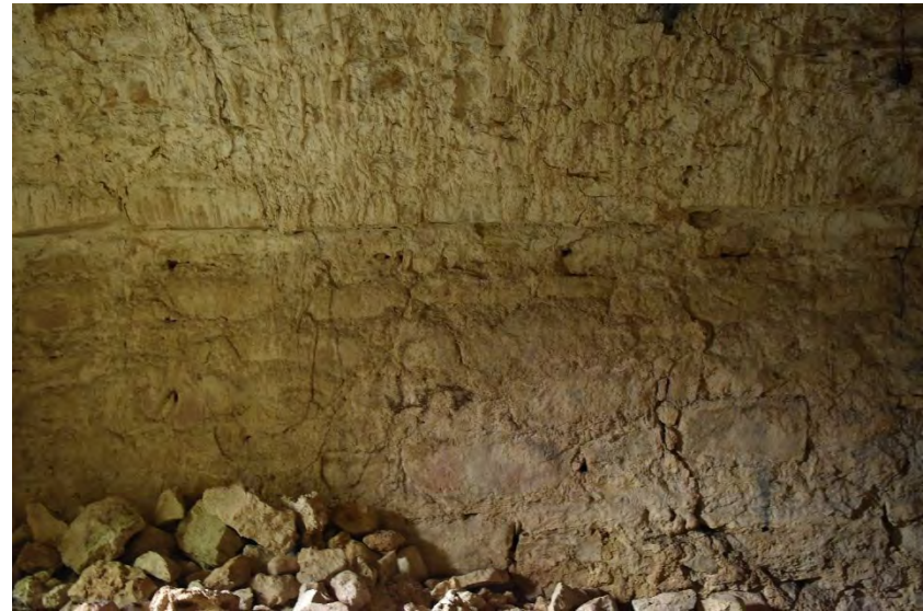
Figura 4.15 Eflorescencias en paramentos y bóveda del Edificio 88, Yaxchilán, Chiapas. (E. Tejeda, 2018).
