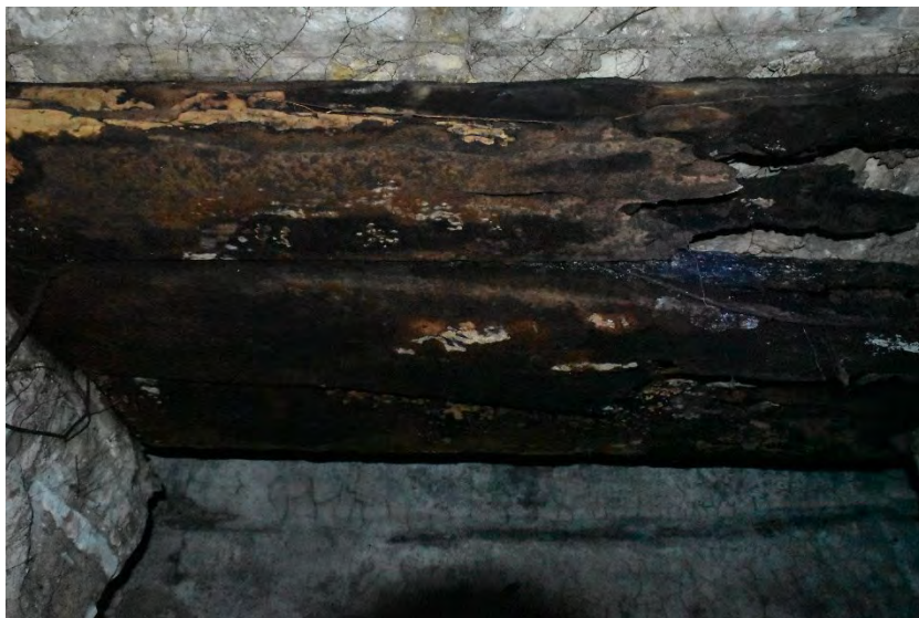
Figura 5.13 Detalle del deterioro del dintel de madera. (E. Tejada, 2016).
