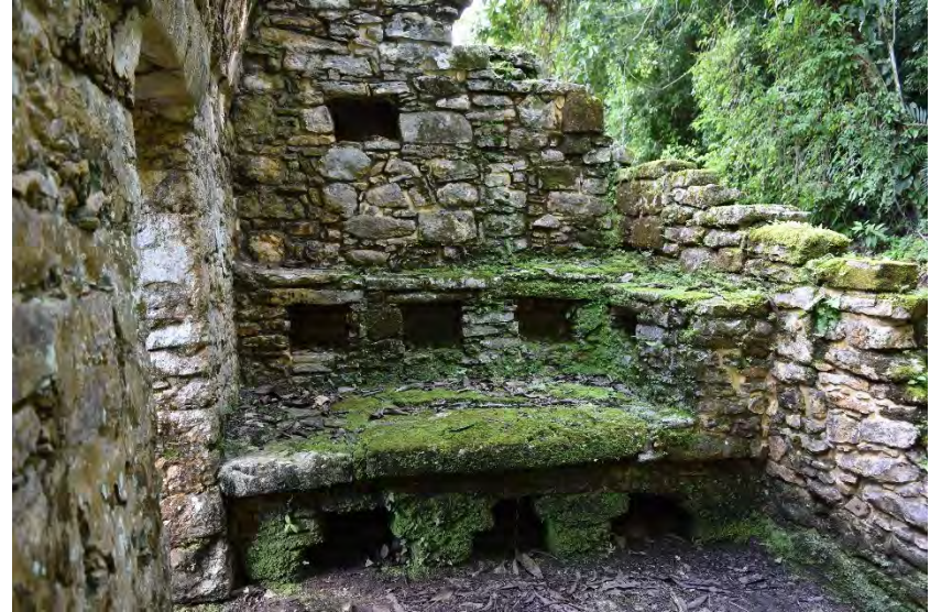
Figura 4.18 Banqueta, Edificio 23, Yaxchilán, Chiapas. Invasión de algas, líquenes y musgos sobre el elemento arquitectónico. (E. Tejeda, 2017).
