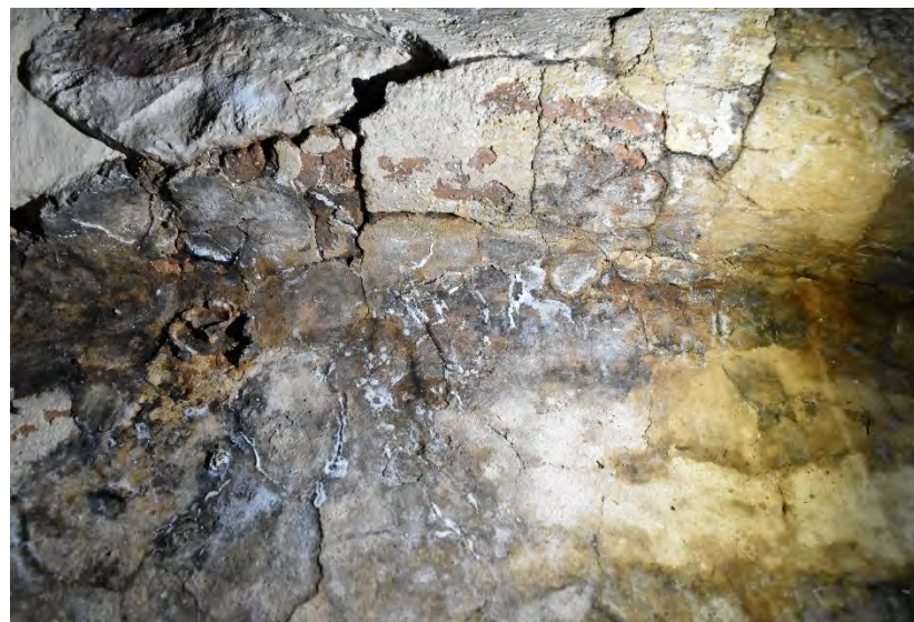
Figura 4.13 Cristalización de sales en el recubrimiento de los paramentos del Edificio 33, Yaxchilán, Chiapas. La existencia de inflorescencias ha causado la pérdida y agrietamiento del aplanado de cal. (E. Tejeda, 2018).
