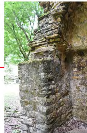
Pulverulencia en el recubrimiento de estuco. Microflora y musgo invaden los elementos arquitectónicos.
