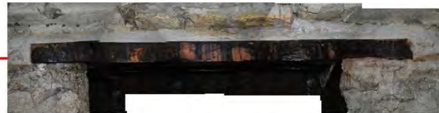
El dintel nuevo se observa completamente húmedo a causa de las filtraciones en la bóveda.
