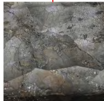
Agrietamiento por migración de sales. Presencia de humedad en el rodapie de todo el muro.
