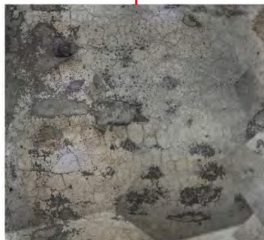
Eflorescencias salinas en todo el paramento.
