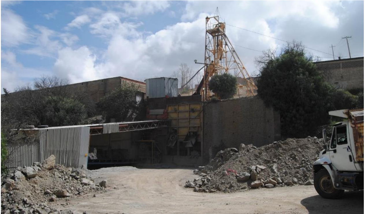
Figura 1.3. Acceso a la mina subterránea mediante el tiro de color amarillo en la unidad minera Vetagrande, Zacatecas.
