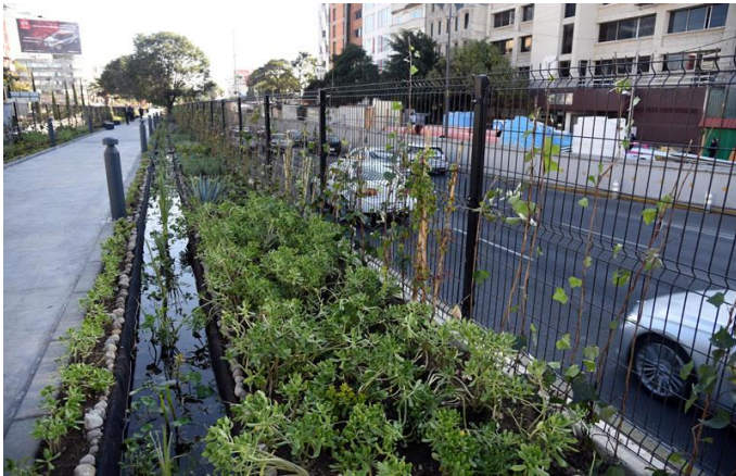
Filtros de agua negra
