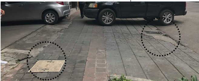
Imagen 17. Registro eléctrico en banqueta sobre Av. Versailles. Elaboración propia.
