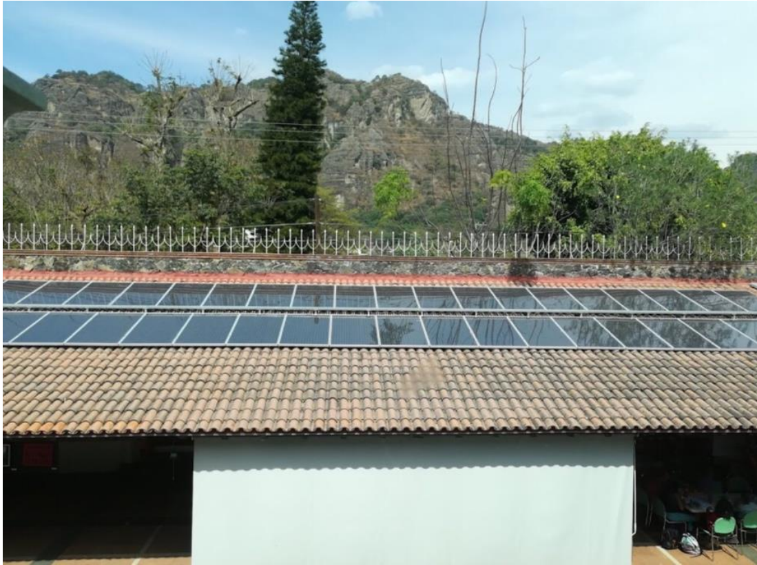
Figura 19: Paneles solares para la producción de corriente eléctrica
