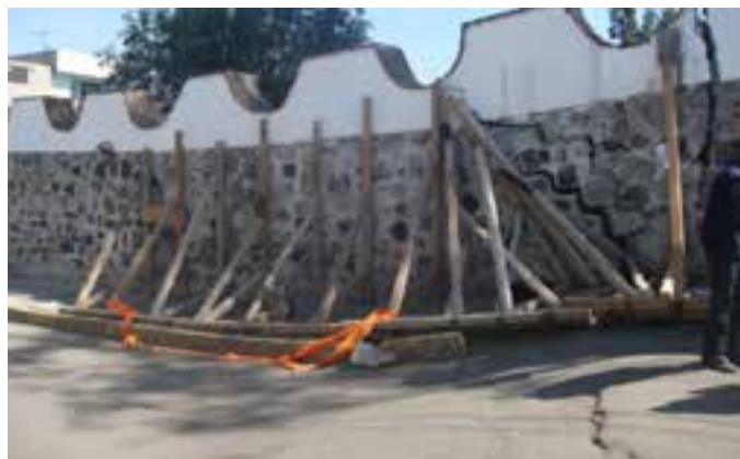
Figura 6.27 - Grietas en la barda del Pantéon de San Andrés Mixquic.
