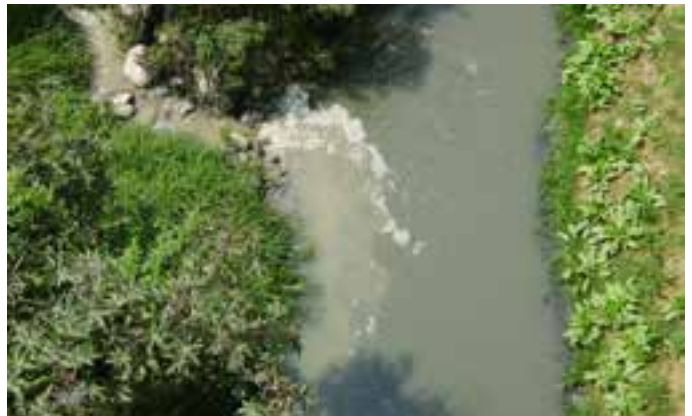
Figura 3.13 - Drenaje conectado al cauce del antiguo río Mixcoac, 2017.
