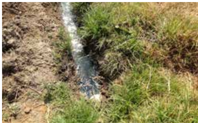
Figura 5.13 - Obstrucción y desaparición de canales.
