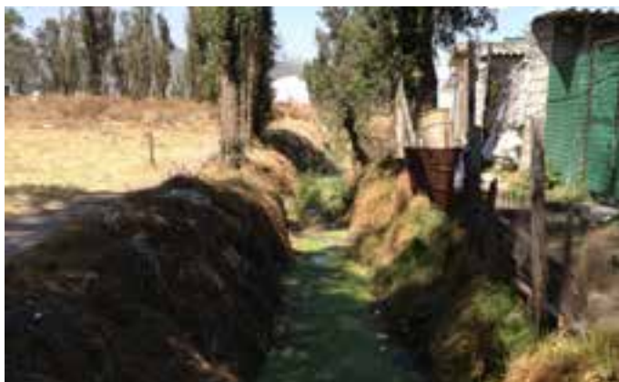
Figura 6.16 - Canal contaminado por desechos de vivienda irregular.
