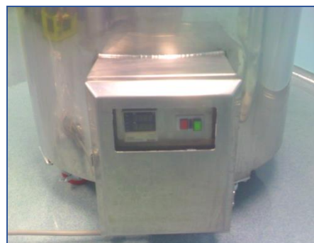
Figura 20. Tablero de control del tanque de servicio con chaqueta de calentamiento para descarga de gelatina. Farmacéutica dedicada a la producción de medicamentos y suplementos alimenticios.
