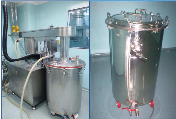
Figura 9. Tanque de servicio para agitación con chaqueta de enfriamiento izquierda, derecha tanque de servicio con cierre hermético para descarga de contenido. Farmacéutica dedicada a la producción de medicamentos y Capsulas de Gelatina Blanda.
