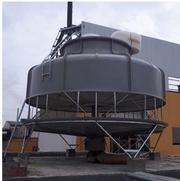
Figura 25. Torre de enfriamiento.
