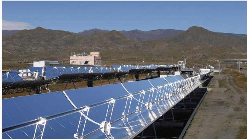
Figura 21. Colectores solares cilindro-parabólicos.
