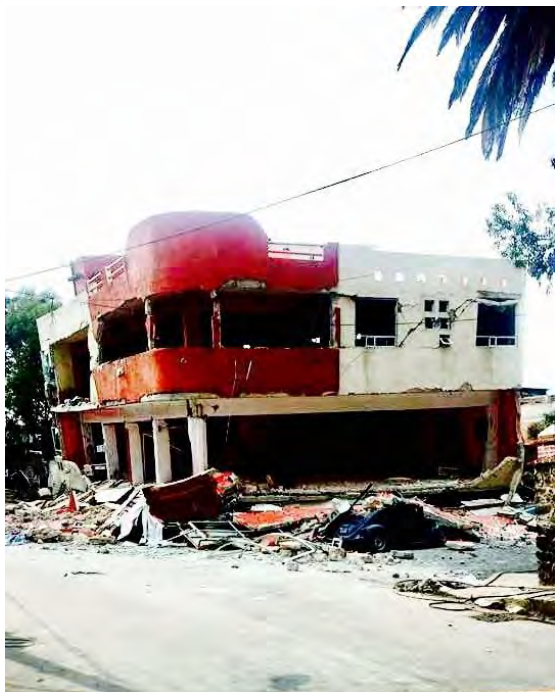
Edificio de tres niveles, se puede observar que los dos primeros niveles colapsaron, Foto tomada por un vecino de la zona, septiembre 2017.
