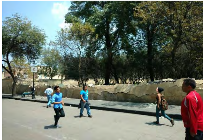
Barda perimetral sobre la calle 16 de septiembre, Foto propia tomada el 19 de septiembre de 2017, horas después del sismo.
