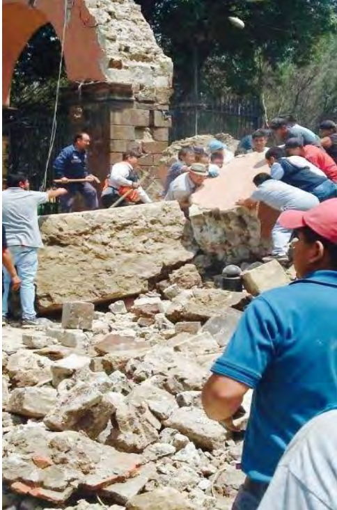
Arcos de acceso al conjunto conventual por el atrio, Foto tomada por vecinos de la zona el día del sismo., donde se puede ver los estragos causados por el siniestro.
