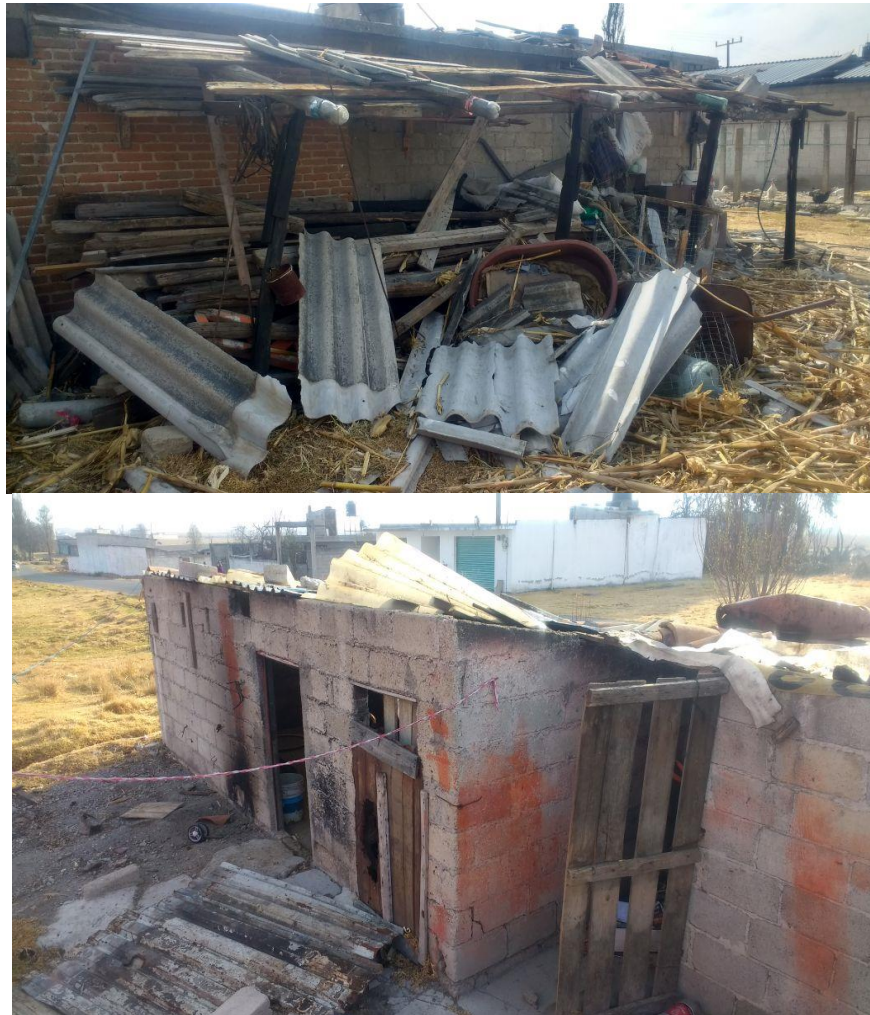
Fuente: Protección Civil del municipio
