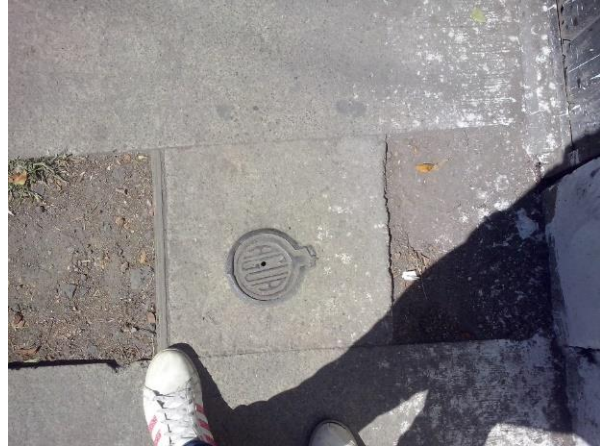
Figura 1.8. Toma de agua potable
