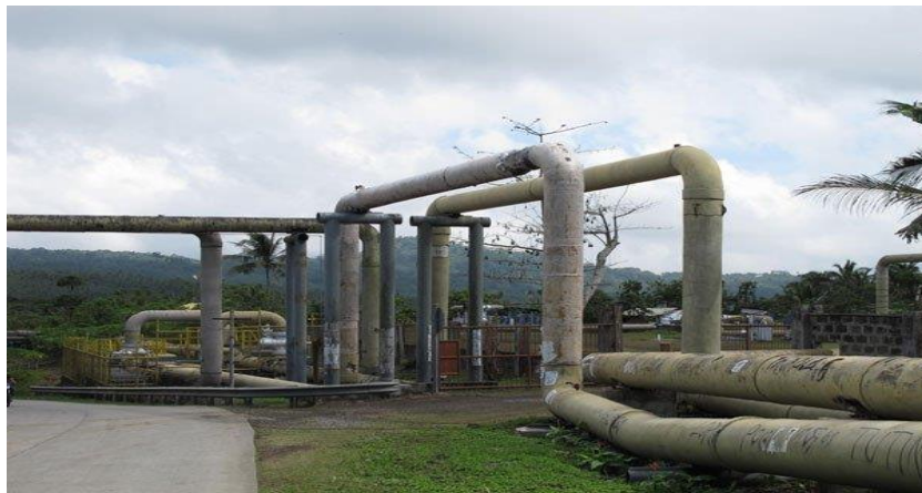
Fig. 9 Complejo geotérmico, Makban (tomada de Makban geothermal power plant fcecocamp.com).
