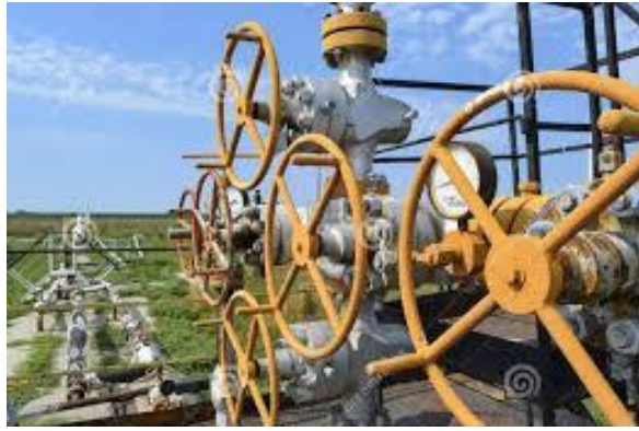
Fig. 3 Instalaciones superficiales de pozos petroleros (tomada de Instalaciones Superficiales, CSIPP).
