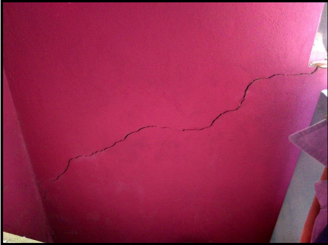
Figura 3.12. Agrietamiento en muro de segundo nivel en dirección de la fig. 3.9.
