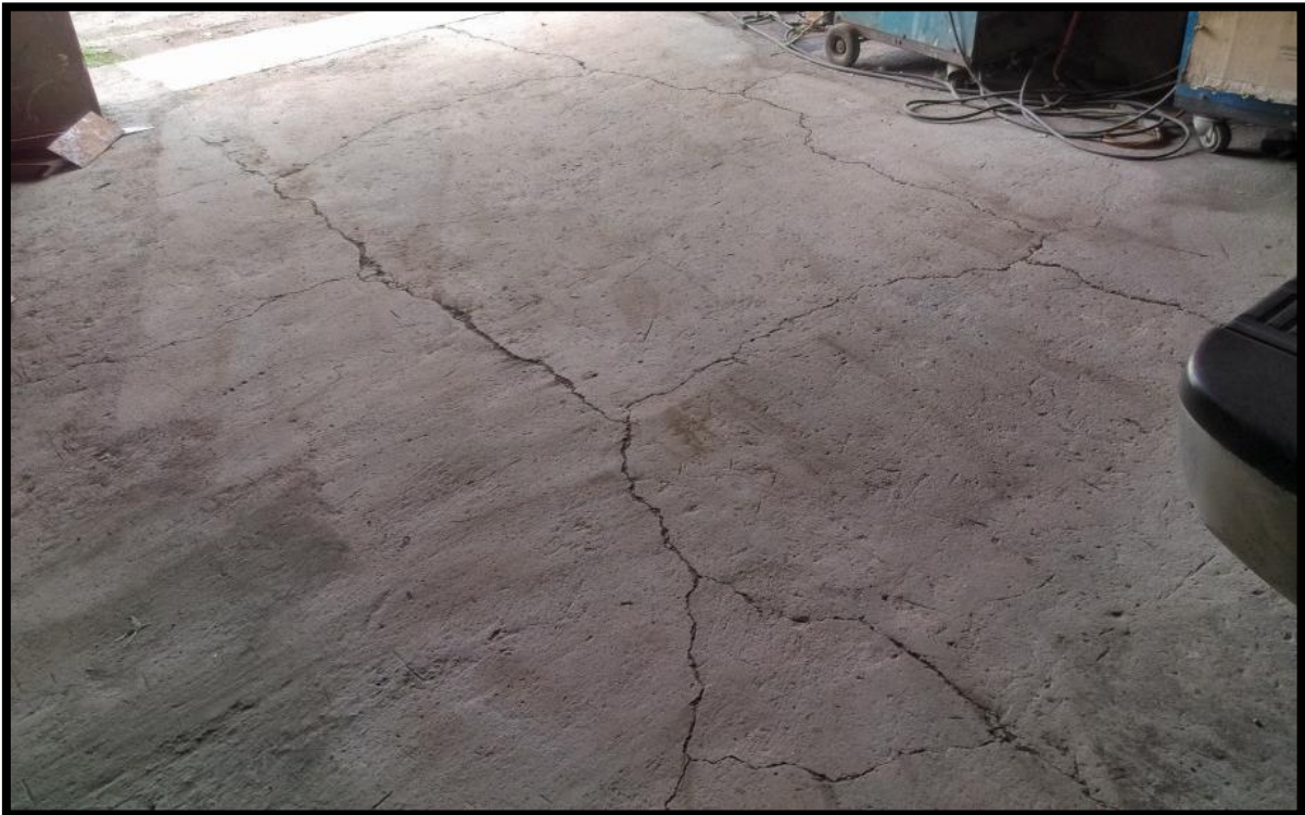
Figura 3.11. Agrietamiento en firme de concreto con malla electrosoldada en cochera y taller de balconeria.
