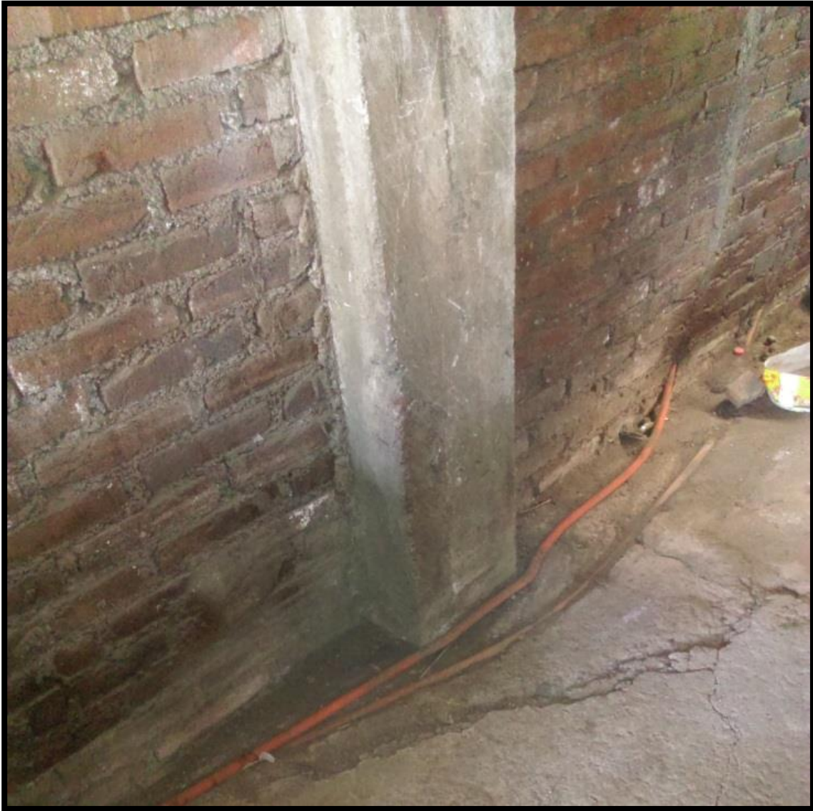
Figura 3.9. Asentamiento Diferencial en una columna de la planta baja.
