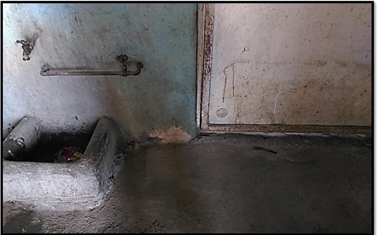
Figura 3.8. Asentamiento notorio cerca de la entrada principal de la construcción.
