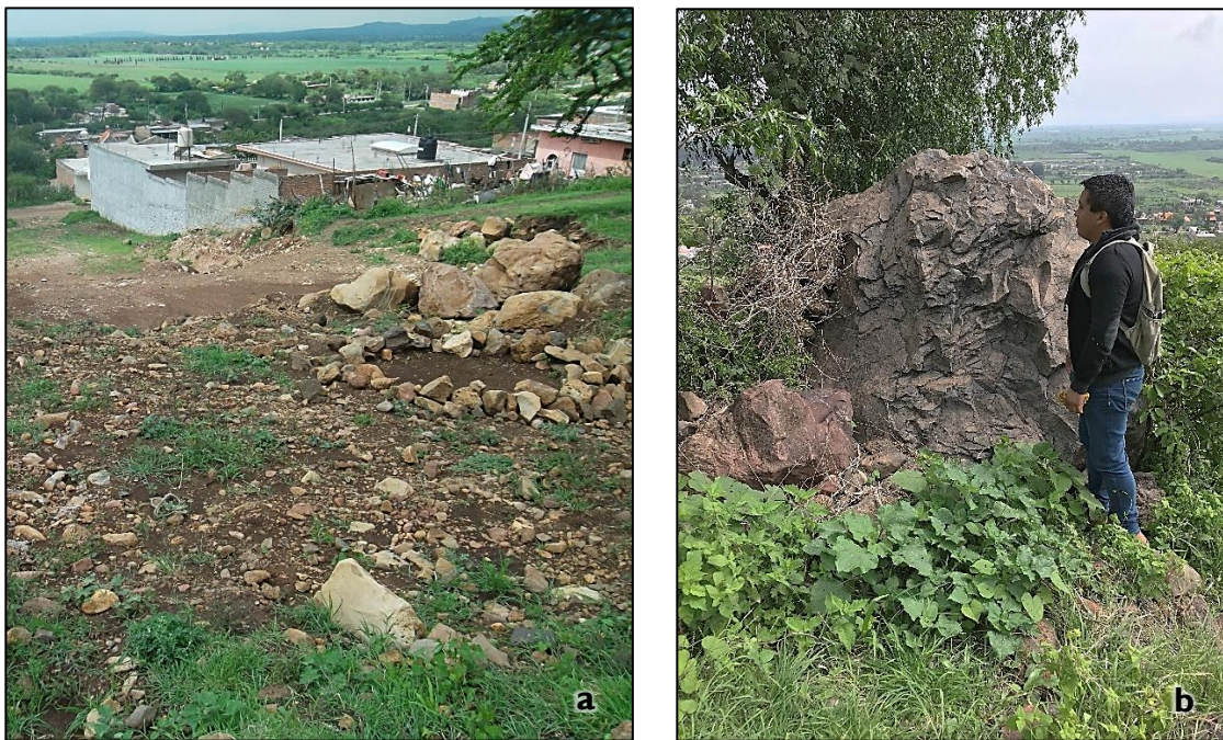
Figura 5.12 Litología de las zonas de tránsito y acumulación: (a) fragmentos de flujos de lava y brecha volcánica al pie de la ladera; y (b) bloque mayor a 2 m de diámetro ubicado en el lomo de la ladera. Fotografías: capturadas en julio, 2018.
