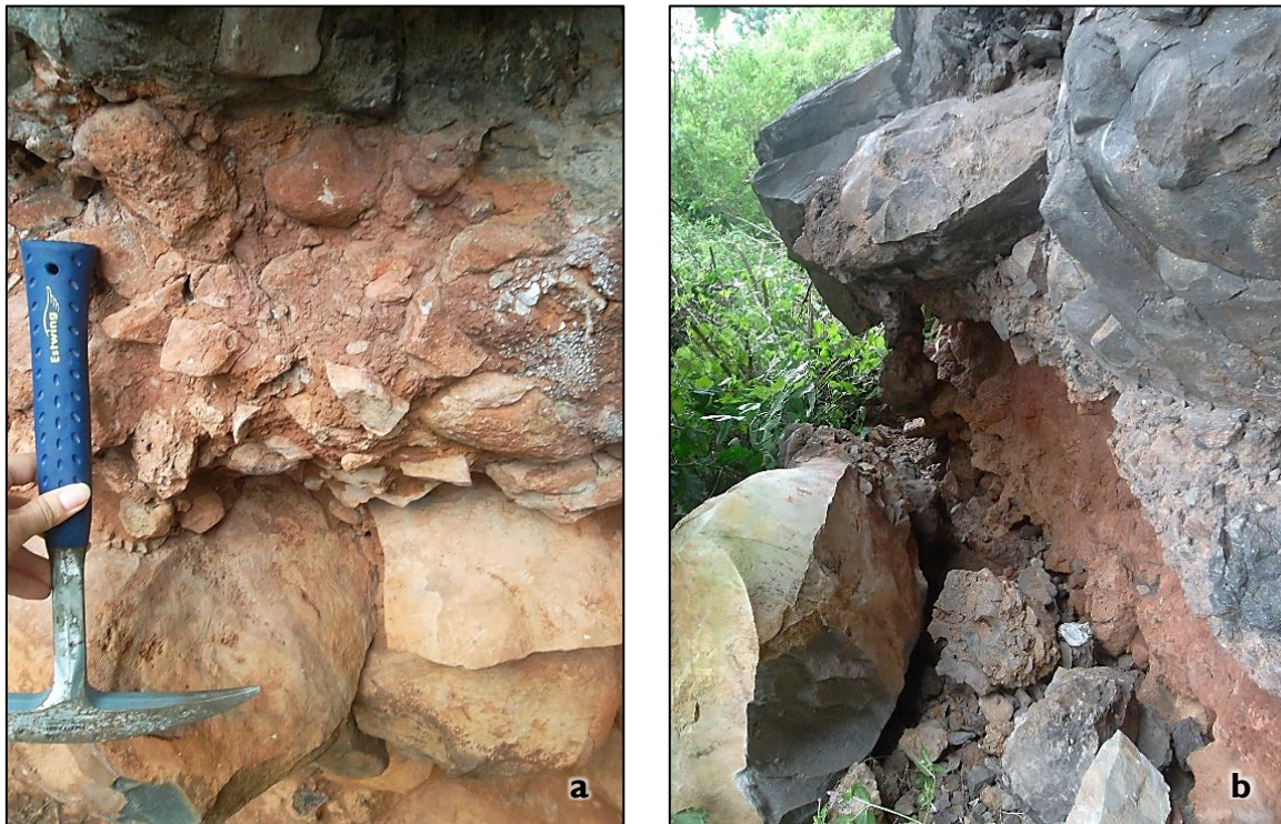
Figura 5.10 Litología de la zona de desprendimiento: (a) paleosuelo en la porción inferior de la corona de la ladera; y (b) erosión diferencial entre el paleosuelo y flujos de lava. Fotografías: capturadas en septiembre, 2017.
