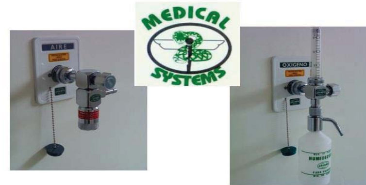
TOMA DE AIRE CON TROMBA DE SUCCION
