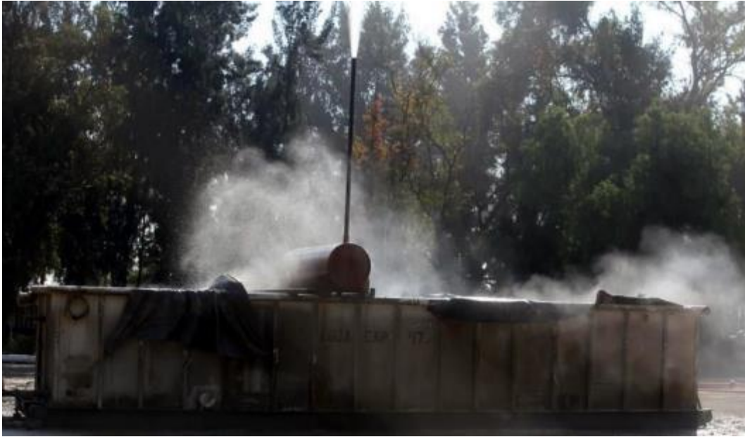
Figura 35. Salida de vapor en pozo de agua de Mixhuca. Reforma.
