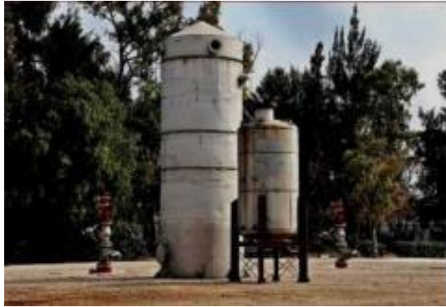
Figura 36. Dispositivos silenciadores de los pozos en Mixhuca. Reforma
