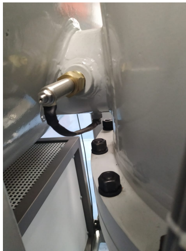
Figura 4.26: Zona de detección de fuga.
