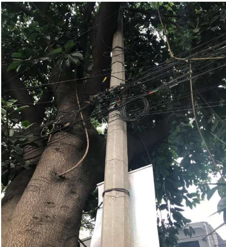
4.40 Acometida eléctrica al sur del predio, Fuente: Héctor Ariceaga
