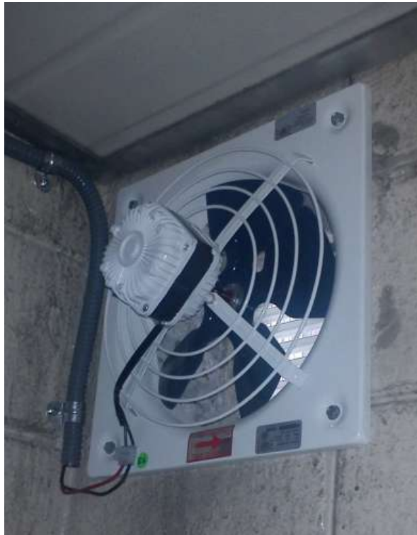
Imagen 2.23 Extractor para cuarto de baterías.
