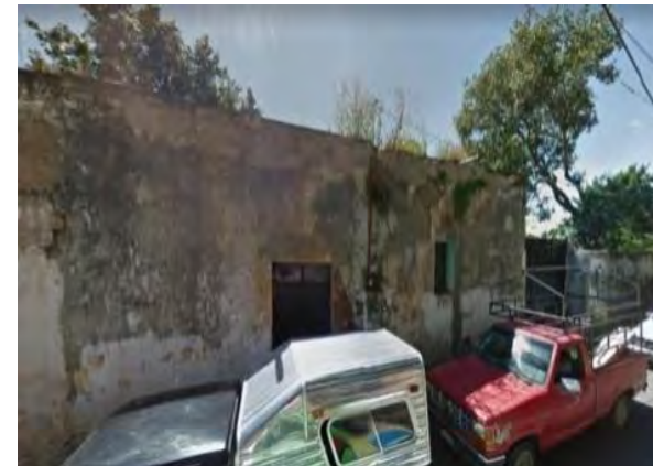
Imagen 13.- Fuente: Fotografía en sitio de fachada de vivienda de calidad precaria.
