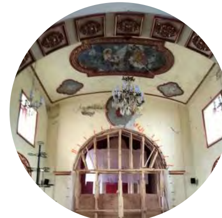
Imagen 269. Daños en el interior del edificio.
