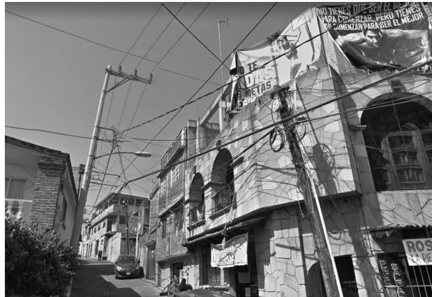
Imagen 138. Red de energía eléctrica.
