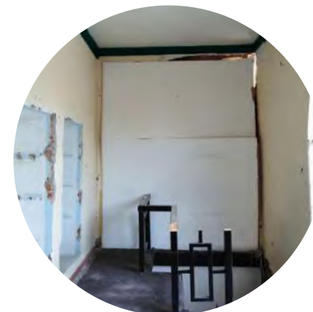
Imagen 270. Muro caído en la zona del archivo.
