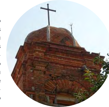
Imagen 268. Fracturas en el campanario.
