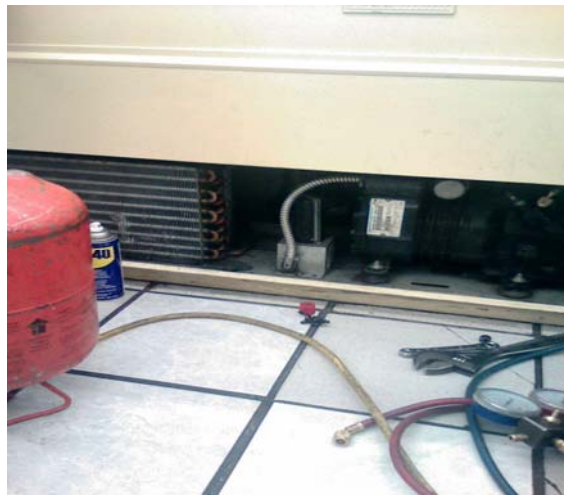
Fig. 41 elementos para recargar de refrigerante entre los cuales se encuentran: manífull (manómetro con manguera roja y azul), perico y boya de refrigerante (naranja).
