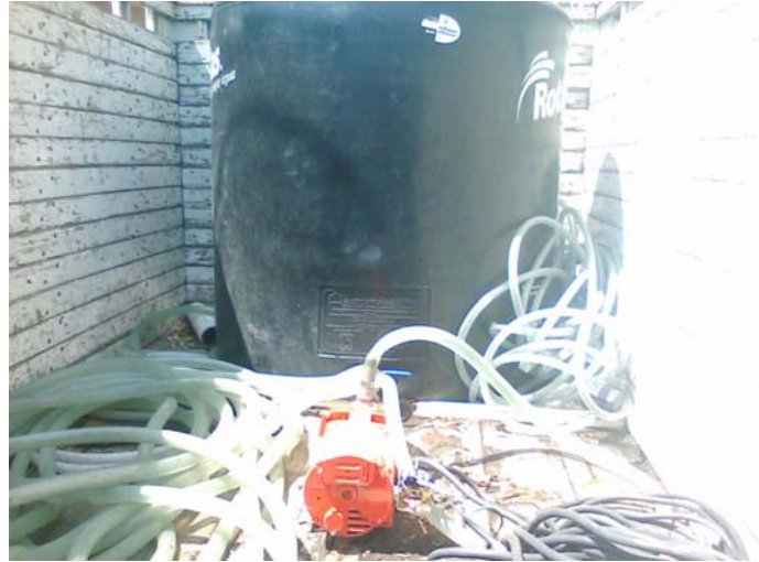
Fig. 26 Elementos transportados para repartir agua a las tiendas. Consta de un tinaco de 1100L una manguera de 1 1/3 pulgadas de diámetro por 30m de largo, Una extensión de 20m de largo de 2 polos y una bomba hidroneumática Evans.
