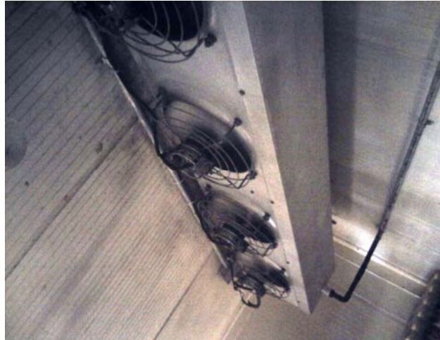
Fig. 31 Difusores de 4 ventiladores se encuentran dentro del cuarto frío
