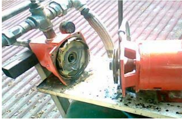
Fig. 28 Muestra al elemento de succión deteriorado por trabajar en vacío
