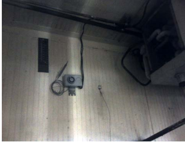
Fig. 39 Tuberías de los difusores congelados por un exceso de polvo en la malla de ventilación ocasionando una temperatura inadecuada en el área de refrigeración
