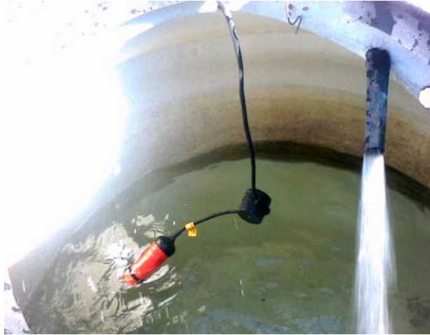
Fig. 43 Interruptor de pera se encarga de activar o desactivar la bomba hidroneumática de manera automática dependiendo si el tinaco esta lleno o vacío y en su defecto si hay o no agua en la cisterna.
