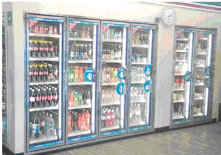
Fig. 22Cuarto frío de tienda 7eleven
