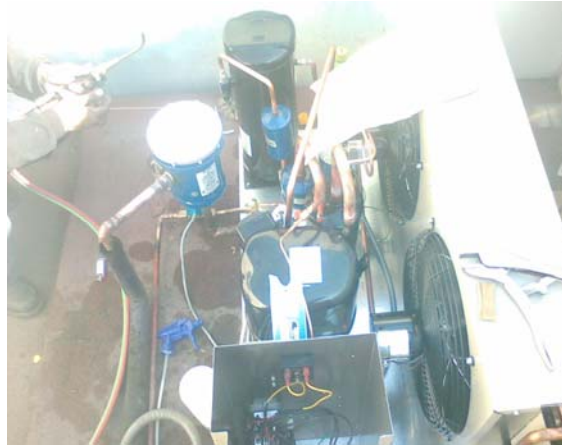
Fig. 33 Condensadores con fugas de aceite en la tubería
