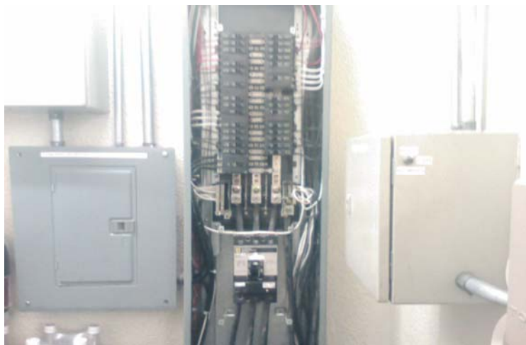
Fig. 24 Tablero principal de alimentación de energía
