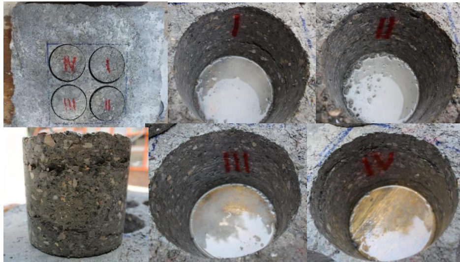
Figura 4.27: Presencia de oquedades en cilindros de artesa 1. Etapa 2
