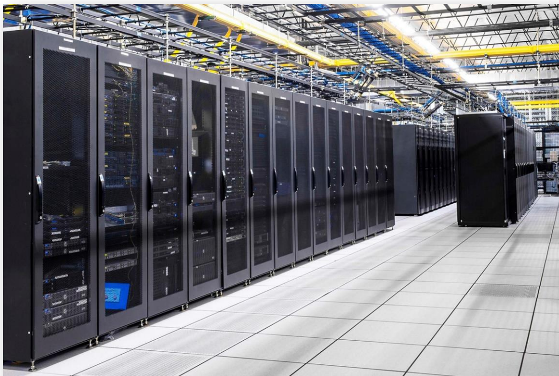
Ilustración 1 - Centro de datos típico. Fuente: ( Integrity, 2018 )
