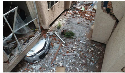
Fotografía 12 Tokio 517. Edificio de viviendas después del sismo. Ortiz, Roberto; 2017..
