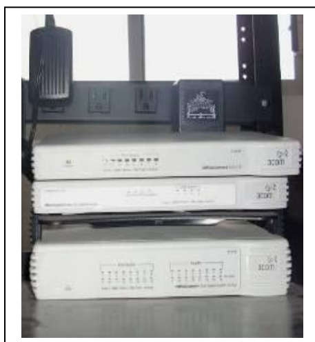
Imagen 6. Switch y router 3COM (alámbrico e inalámbrico)
