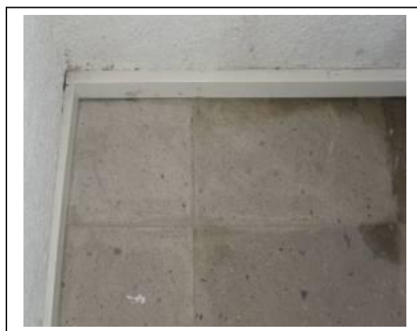
Imagen 23. Canaleta a ras del suelo
