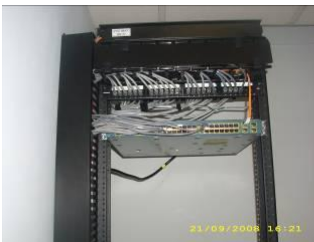
Imagen 33. Panel de parcheo terminado y conectado al switch
