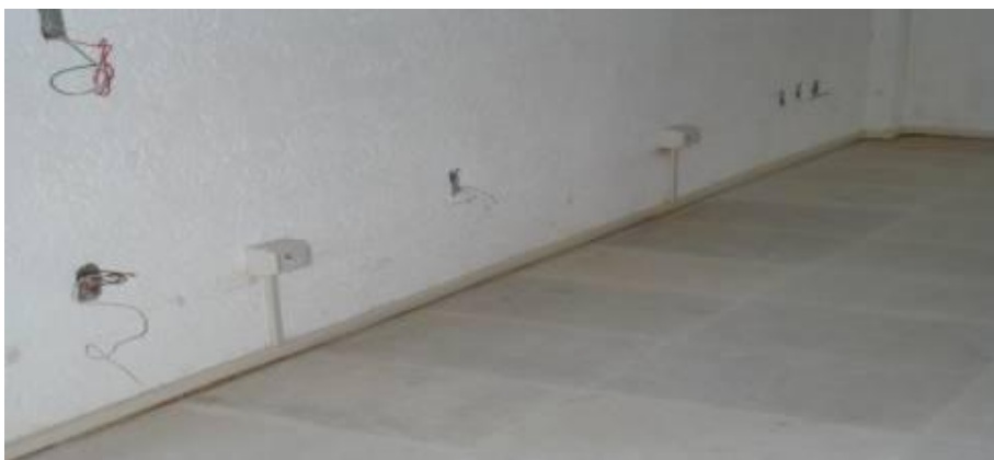
Imagen 27. Canaleta en primer piso
