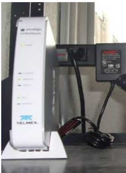
Imagen 4. MODEM 2 wire proporcionado por Telmex
