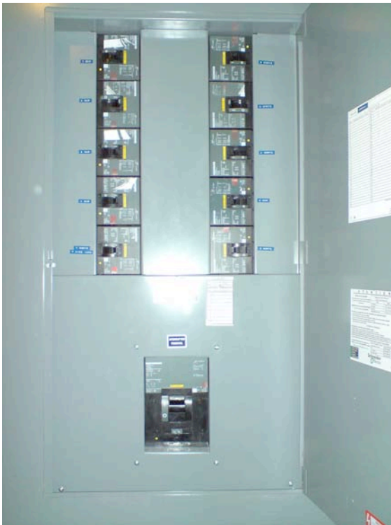
Vista de tablero con tapa
