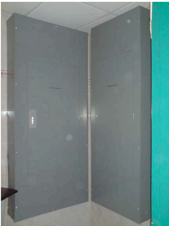
Vista de tableros normal y de emergencia ya instalados y operando
