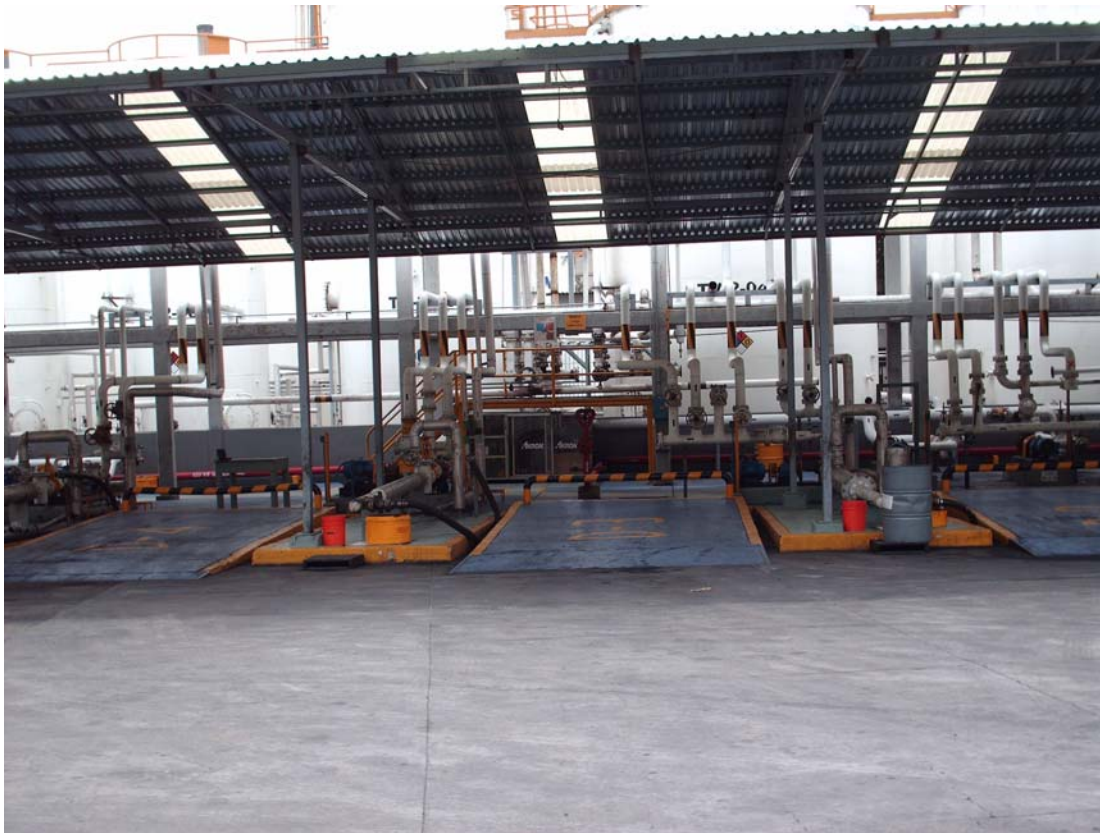
Fig. 1, área de descarga para auto-tanques
