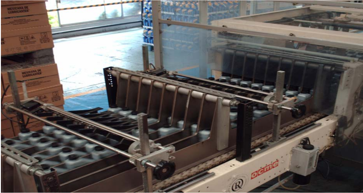
Fig.7, transportador de acumulación mediante la alineación y separación en 8 divisiones
