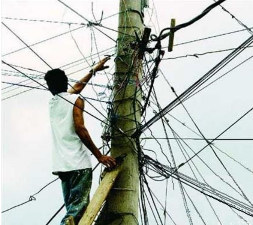
Figura 10 punto de conexión sin blindaje
