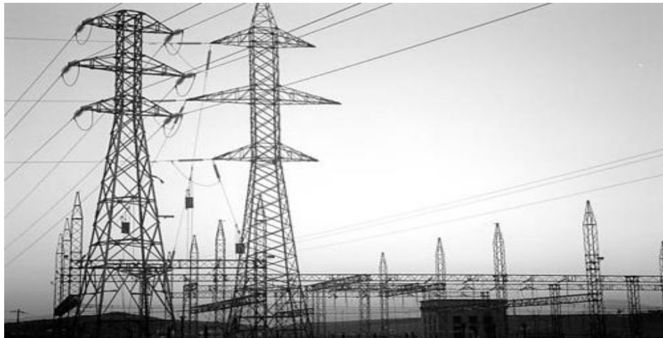
Figura 13 La energía llega desde las generadoras a las subestaciones a través de de las redes de transmisión. Idealmente una subestación debe de estar situada en el centro del área de servicio.
