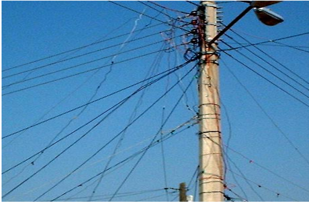
Figura 9 Red aérea de 4 conductores desnudos que facilita la conexión ilícita
