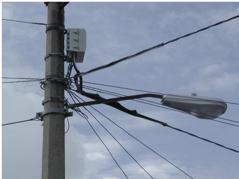
Figura 11 Punto de conexión con caja antifraude y BMCU protegido
