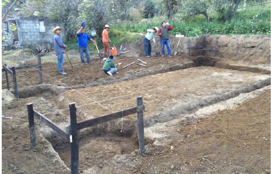
Imagen Nivelación, trazo y excavación del suelo-cimiento con la innovación de los planos sustentadores en cada esquina.
