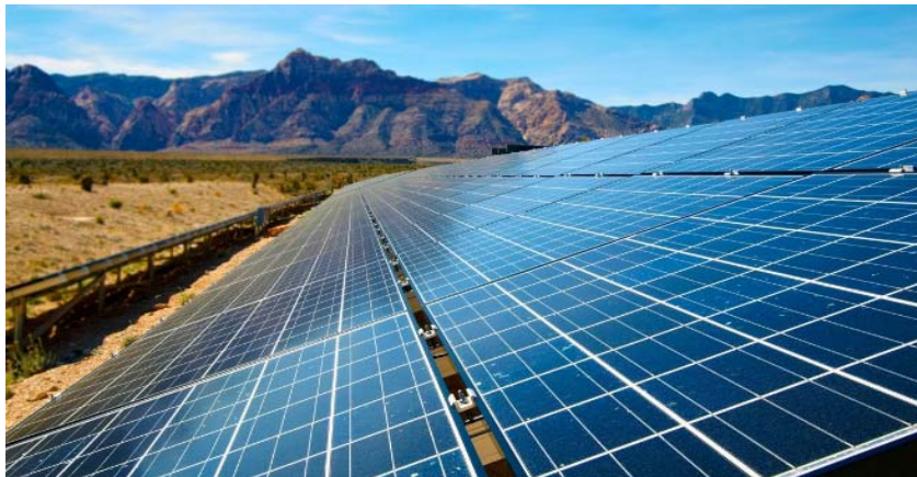
Figura 2.5. Imagen de paneles fotovoltaicos.
