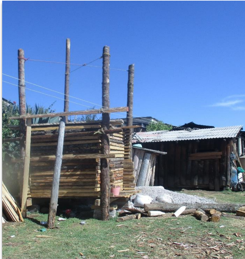
Ilustración 16: sincolote de maíz en proceso de construcción al lado de cocina tradicional
