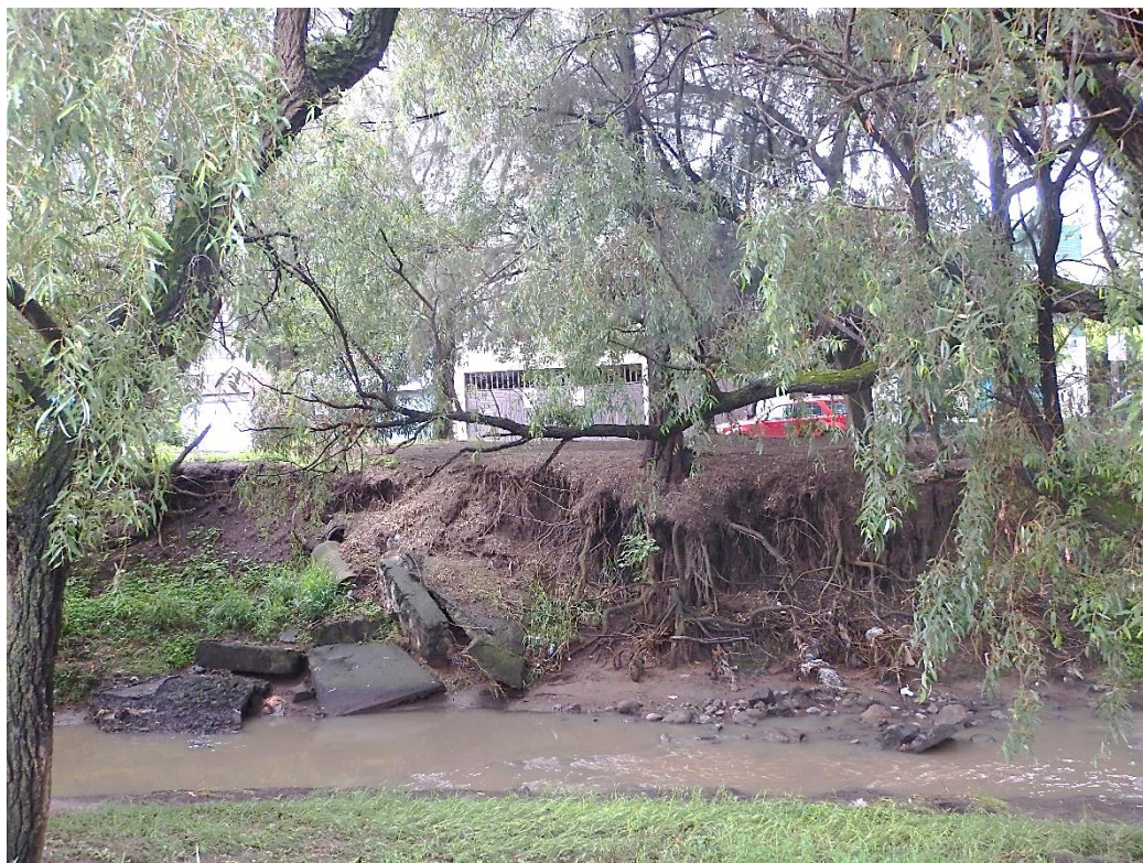
Figura 33. Fragmentos de infraestructura obsoleta de drenaje (Arroyo-Robles, 2018).
