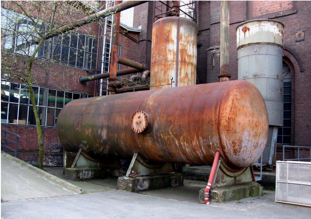
Figura 1.3.2.2 Corrosión atmosférica de caldera [9].
