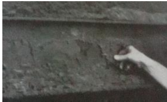
Figura 1.3.2.3 Delaminación de placa de acero al carbono debido a SO_2 , la ceniza se deposita fuera del área de caldera de una planta eléctrica de carbón. [5]
