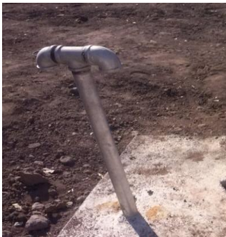
TUBO DE VENTILACION
