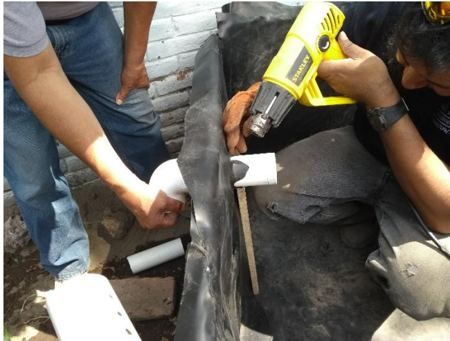
Figura 25. Tubería de entrada de agua residual a tratar en el HAM.
