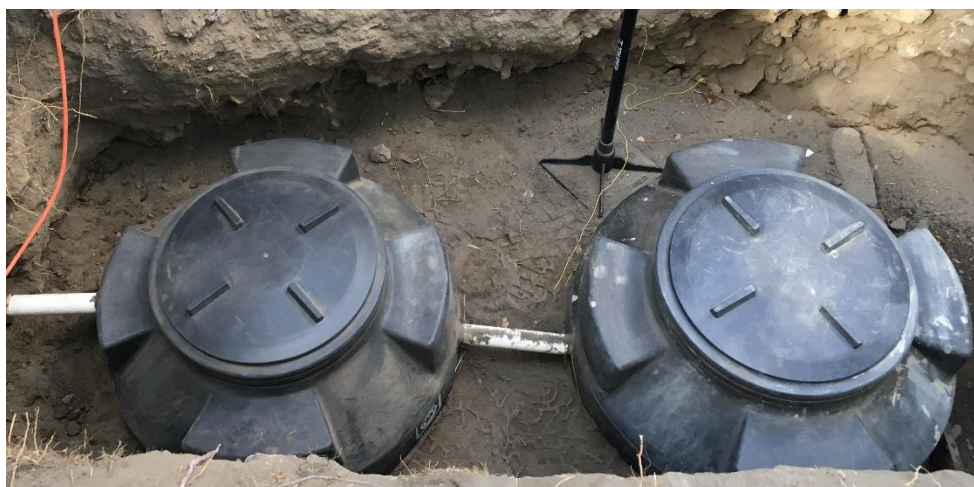
Figura 24. Conexión entre tanques.
