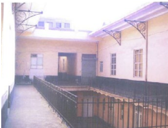
FOTOGRAFÍA 67 Estado en el que se encontraba el edificio cuando fue abandonado por sus residentes.
