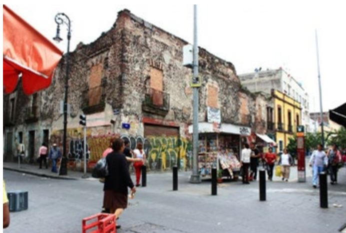
FOTOGRAFÍA 58 Estado de algunos inmuebles que se encuentran en el Centro Histórico, los cuales suelen ser ocupados por población vulnerable.
