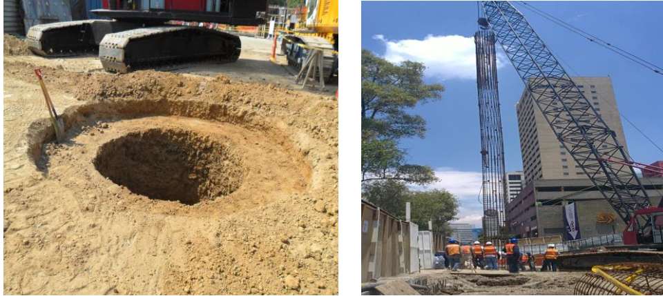
Figura 32. Excavación para construcción de brocal e izado de acero de refuerzo para pila. Fuente: Cortesía del proyecto Marina 385
