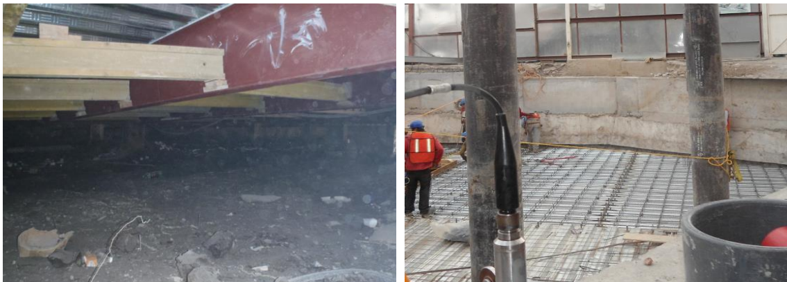
Figura 41. Excavación al nivel -3.0 m, apuntalamiento y armado de losacero. Fuente: Cortesía del proyecto Marina 385
