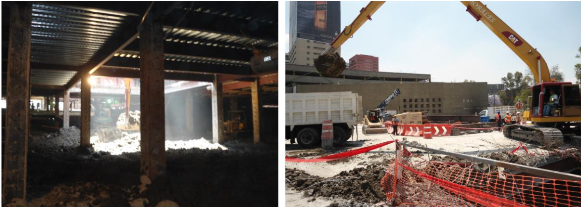
Figura 40. Retiro de material en lumbrera y carga de material producto de la excavación. Fuente: Cortesía del proyecto Marina 385
