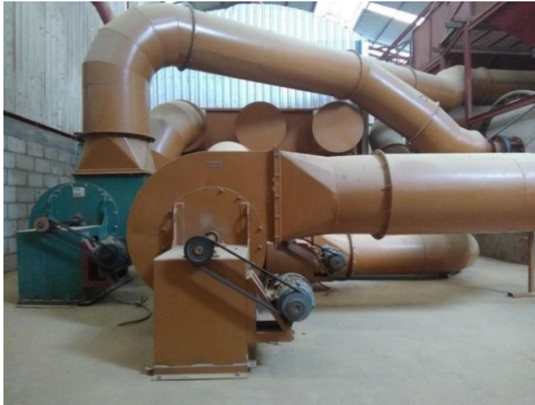
Figura 30. Tuberías que transportan el aire caliente a la salida de la caldera.
