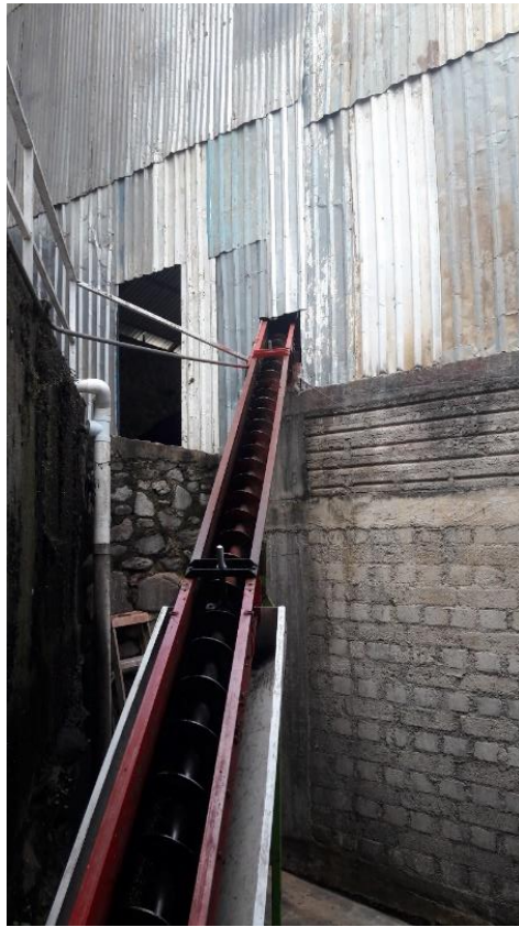
Figura 25. Tornillo helicoidal encargado de transportar la pulpa hacia la bodega de almacenamiento.
