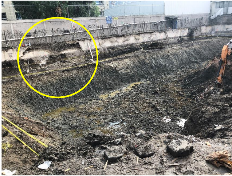
Figura 33. Anomalía constructiva en el muro Milán
