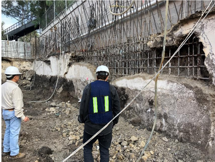
Figura 34. Anomalía en el muro de contención
