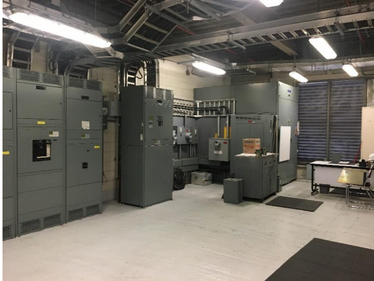
Imagen. - Subestación Eléctrica 55
