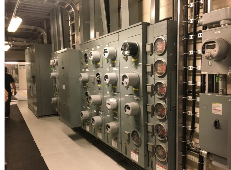
Imagen. - Tablero de Medidores 56
