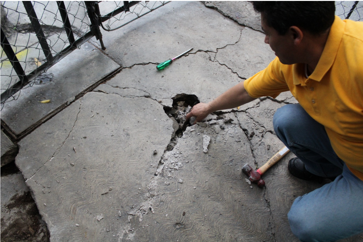
Patio de una casa dúplex que se ha fracturado debido al hundimiento del mismo inmueble. – Foto propia
