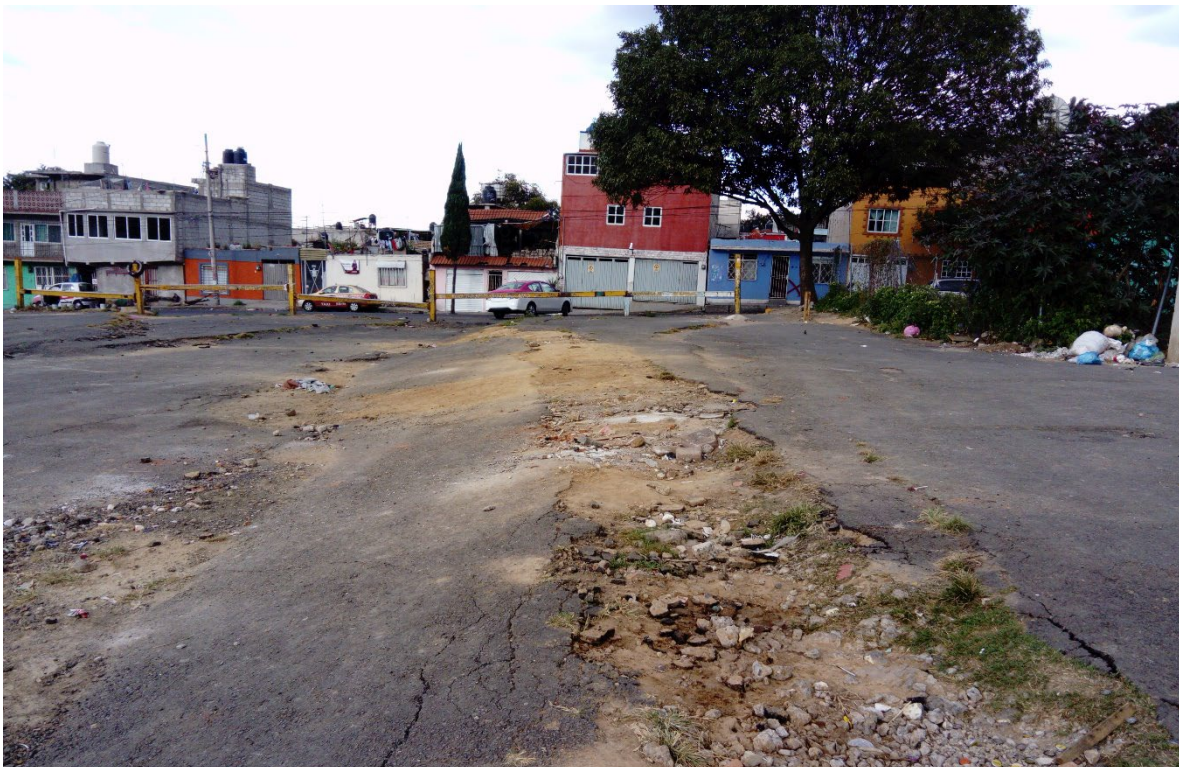
Hundimiento de una sección de la zona en tres partes con una diferencia de 50cm cada uno. - Foto propia
