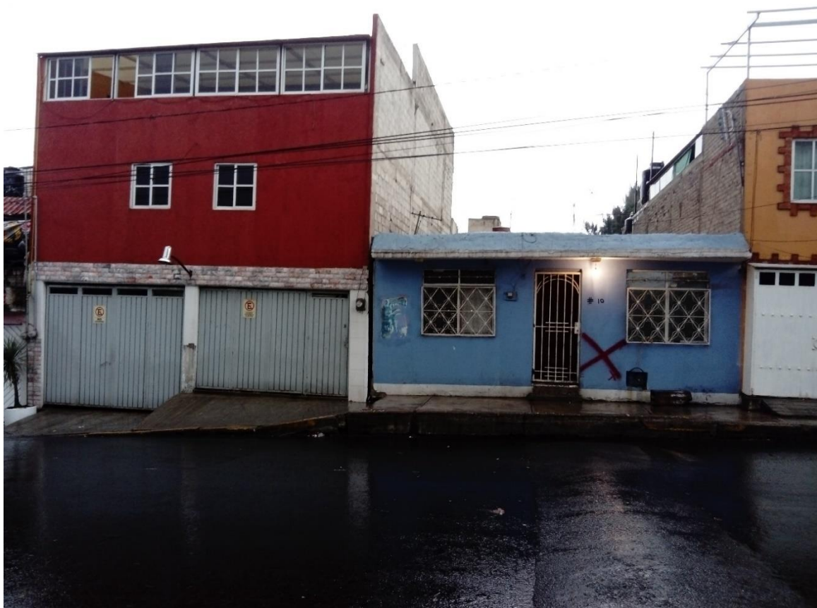
Casa afectada por el sismo de septiembre del 2017. Colinda con una edificación nueva que se ha separado tras este hecho. – Foto propia
