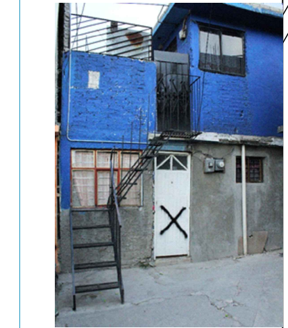
CONSTRUCCIONES IRREGULARES ⑤
