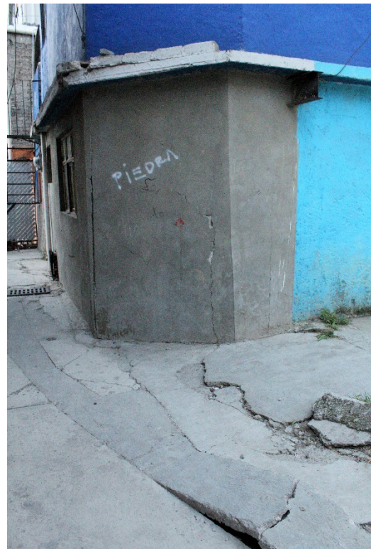
Daño de muro de carga y castillo tras sismo – Foto propia
