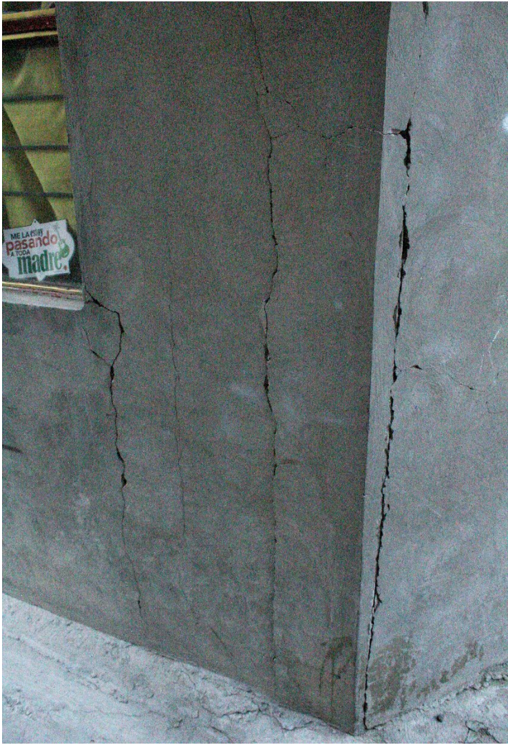
Se observa el daño que sufrió la pared y como el castillo se estrelló debido a la ampliación del piso superior. – Foto propia
