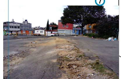
FALLA GEOLÓGICA ⑦
