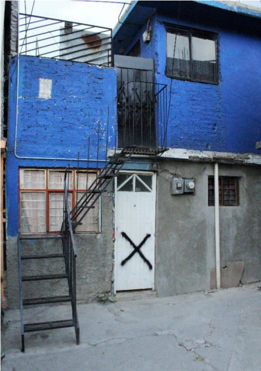
Casa con daño total tras sismo – Foto propia
