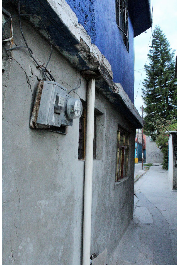
Agrietamiento en el acabado, no solo se agrietó el acabado si no también daño en la estructura del muro. – Foto propia
