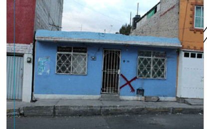
DAÑO DE ESTRUCTURA ③
