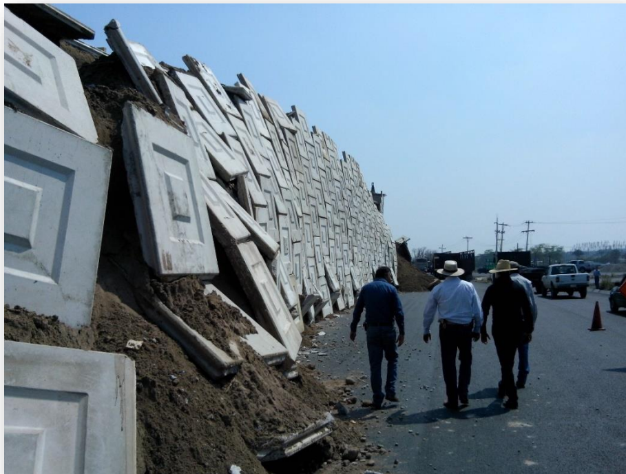
Ilustración 10. Vista frontal de la falla ocurrida en el muro mecánicamente estabilizado.
