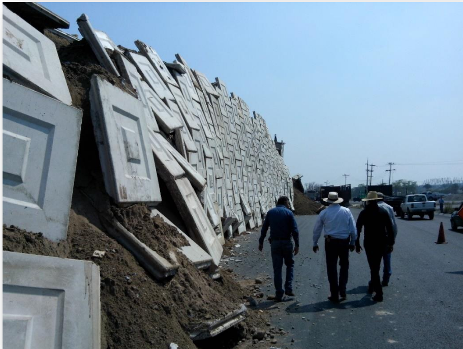
Ilustración 1. Falla ocurrida en el muro mecánicamente estabilizado "Tamaca".
