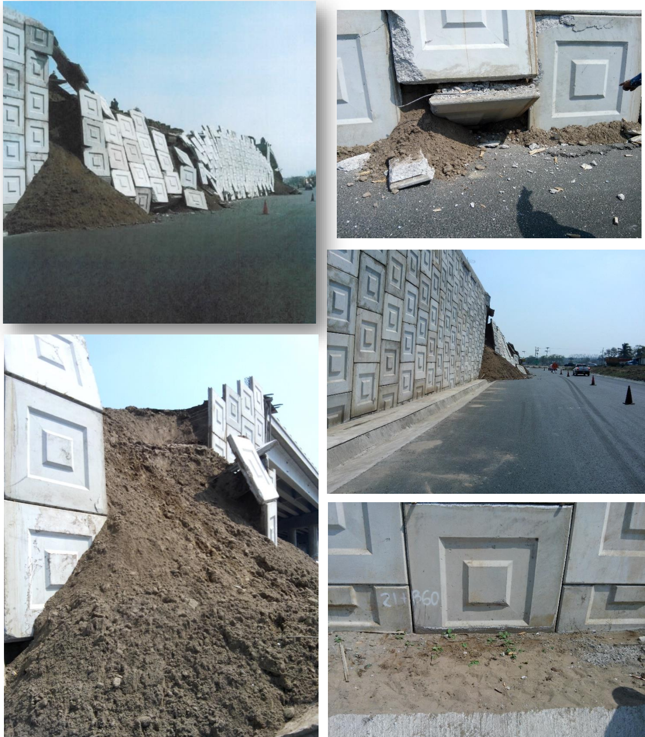
Ilustración 11. Vistas de la falla ocurrida.
