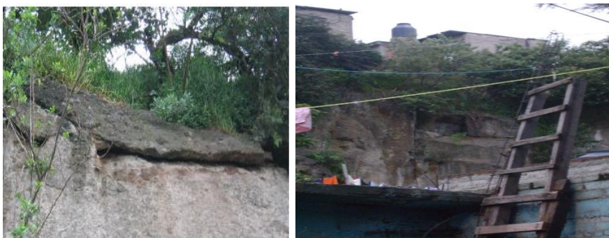
Figura 71-72. Muestran condiciones precarias de estabilidad y rocas desprendidas con diámetros aproximados de 2 m. Elaboración propia.
