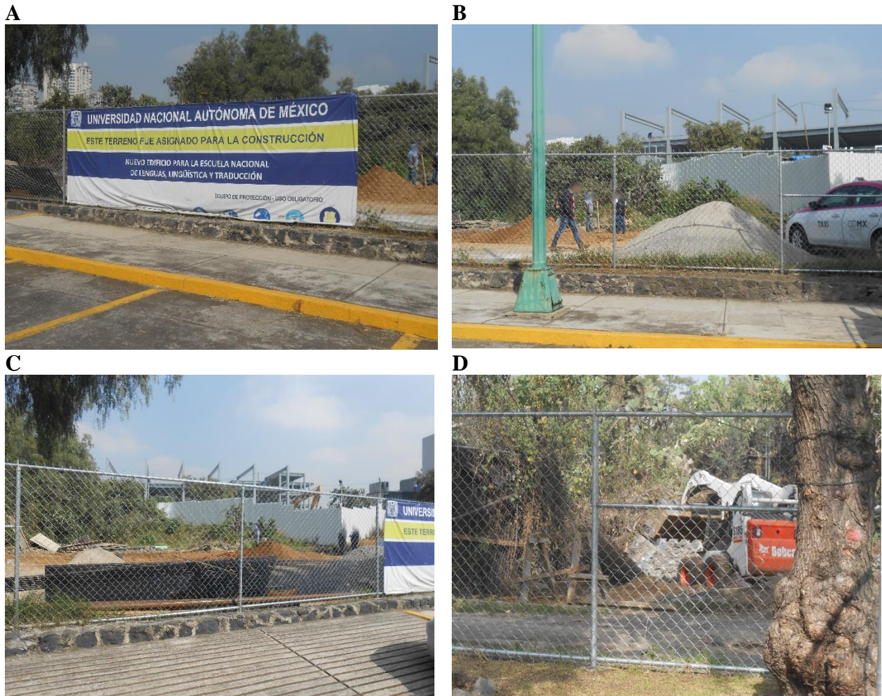
Figura 6.1. Construcción del nuevo Edificio para la Escuela Nacional de Lenguas, Lingüística y Traducción en la porción nororiental de la unidad de estudio 7. A, lona informativa sobre la construcción que se está realizando en la zona; B, perspectiva de la construcción; C, perspectiva de la construcción; D, maquinaria removiendo roca.
