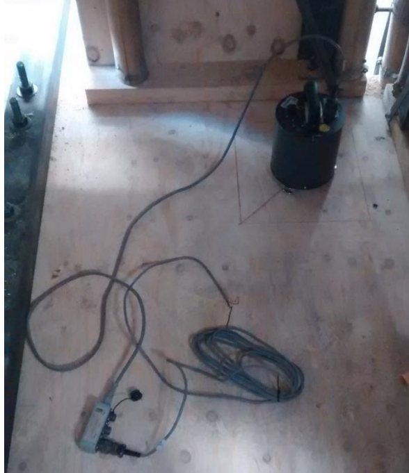
Figura 4.1.7 Fotografía de uno de los cinco equipos colocados en el primer nivel.
