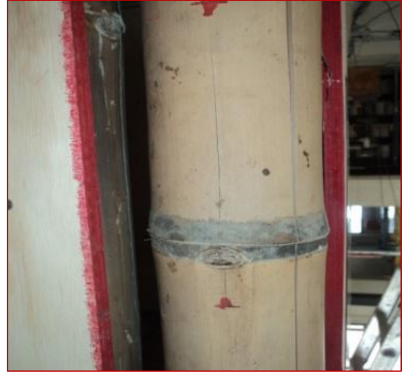
Figura 6.2 Fotografía que muestra fisuras verticales en una columna de bambú en el primer nivel.
