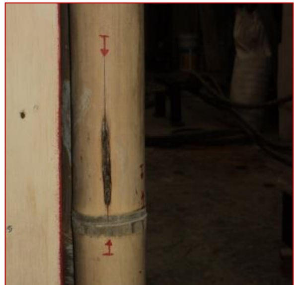
Figura 6.4 Fotografía que muestra fisuras verticales en una columna de bambú en planta baja.
