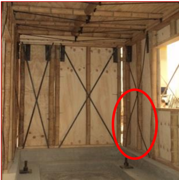
Figura 6.3 Fotografía que muestra la parte interna de la planta baja de la casa. En el óvalo rojo se observa la deformación de los contravientos en el interior de la estructura.
