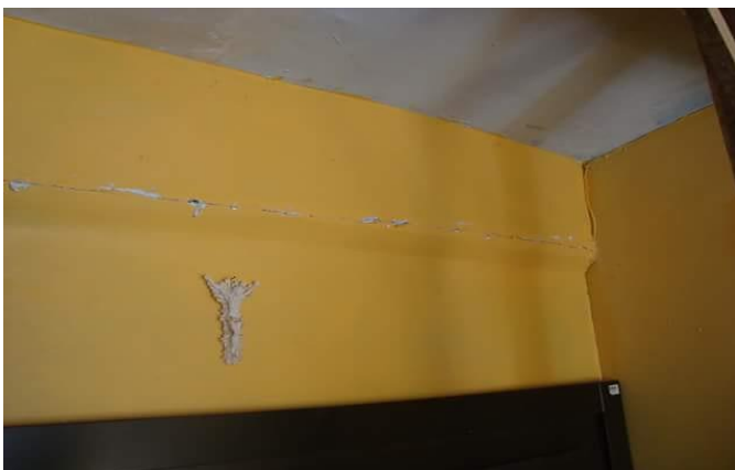
Grieta en trabe: daño estructural
