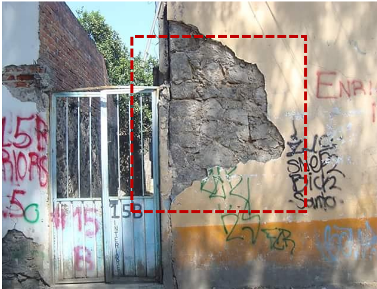
Grietas en Muros con daño NO estructural.
