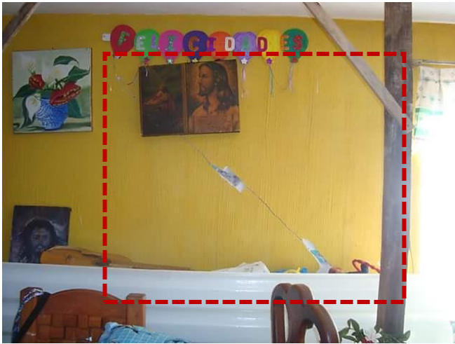
Muro con grieta en la parte interna y externa: daño estructural= con riesgo de colapso
