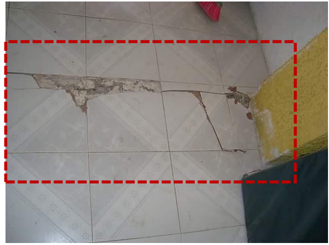
Grietas en azulejos de piso: daño superficial.
