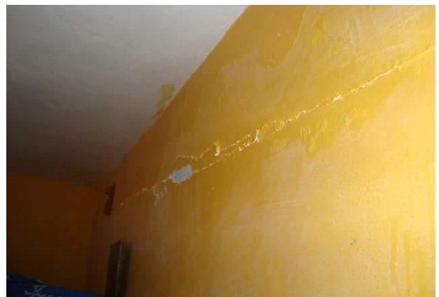
Muro con grieta en unión a la trabe: daño estructural
