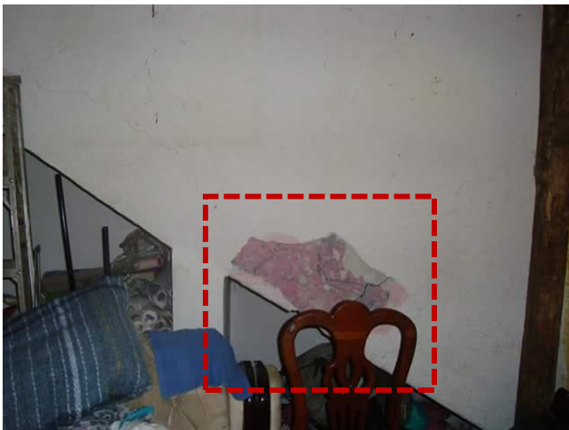
Muro de escalera con grieta: daño estructural= con riesgo de colapso
