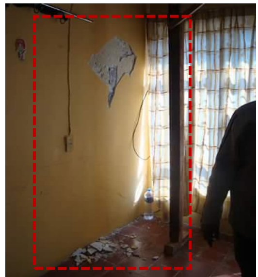
Losa sin daño estructural. Planta alta con movimiento al acceder
