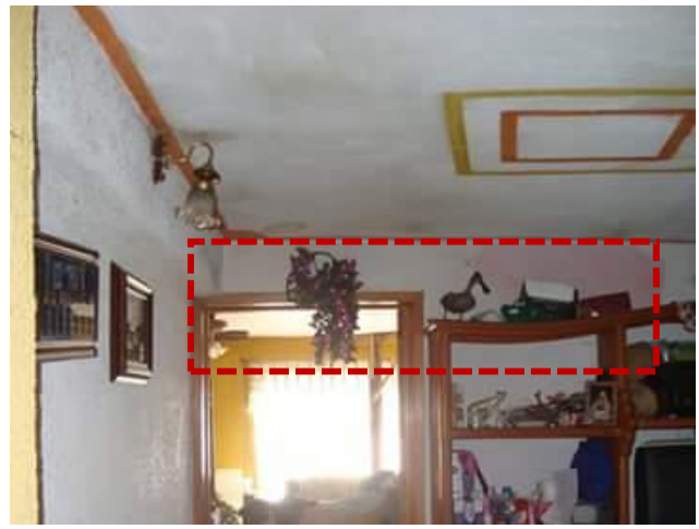
Trabe sin daño estructural anexada por falta de estructura
