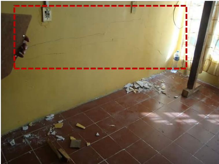
Muro con grieta en diagonal: daño estructural= con riesgo de colapso
