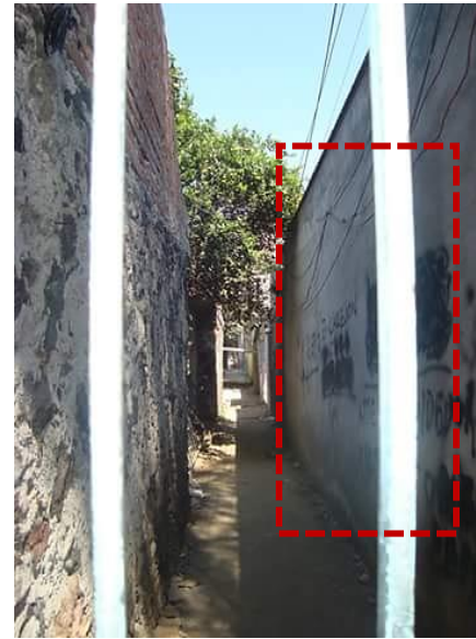
Grietas en Muros con daño NO estructural.
